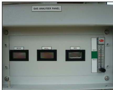
Landfill Gas Analyser panel
